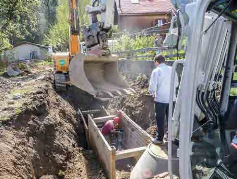
Tiefe Kanäle, hier ca. 4 m, können nur im Schutze eines Grabenverbaus errichtet werden.
