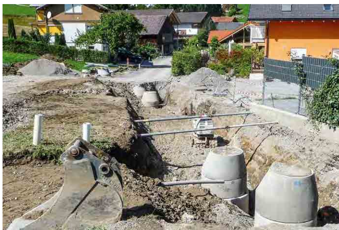
Der Regen- und Schmutzwasserkanal braucht den ganzen Straßenraum. Das geht nur mit „Unterstützung“.
