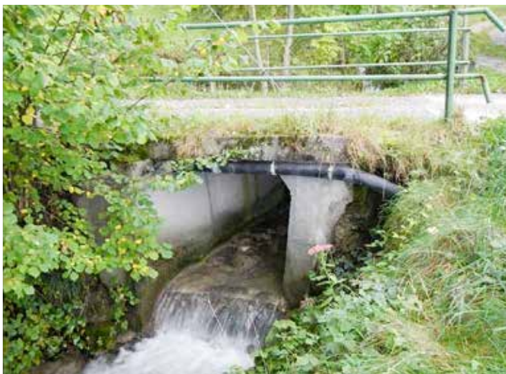
Der Durchflussquerschnitt der alten Rofelbachbrücke war zu klein.
