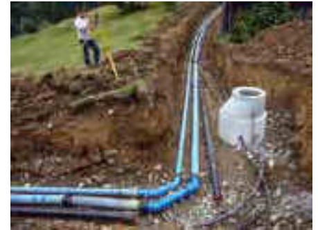
Die Zu- und Ableitungen zum HB werden eingemessen, der Graben wird dann verfüllt.
