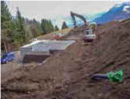
Der Hochbehälter wird überschüttet. Zum einen aus optischen Gründen, zum anderen bleibt das Wasser kühl.
