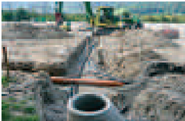
Kabel, Leerrohre, Steuerleitungen, Drainagen, ...
