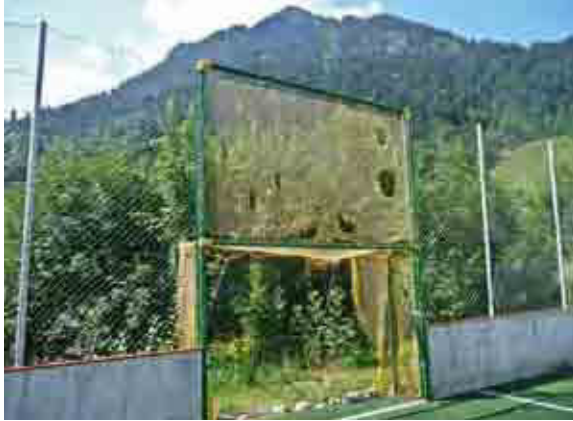
Die beschädigten Netze mussten ausgetauscht werden.
