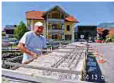
Die obere Armierung wurde entrostet und mit Korrosionsschutz behandelt. Der nächste Schritt ist das Aufbringen des Saniermörtels.
