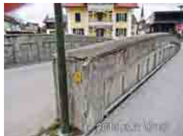
100 Jahre gehen auch an Beton nicht spurlos vorüber.
