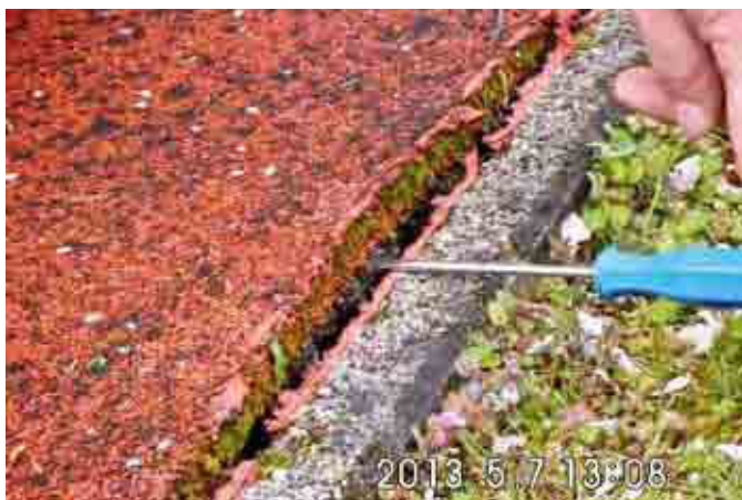
Der Kunststoffbelag löst sich von der Randeinfassung.
