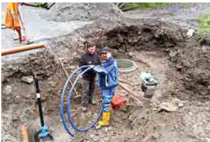
Unser Wasserwerk verbessert gleichzeitig die Wasserversorgung.
