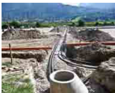
Die Leitungen müssen außerhalb des Spielfelds verlegt werden.
