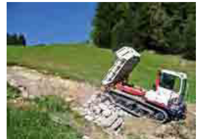
Der Steinsatz dient als unterirdische Stütze für den rutschgefährdeten Hang.
