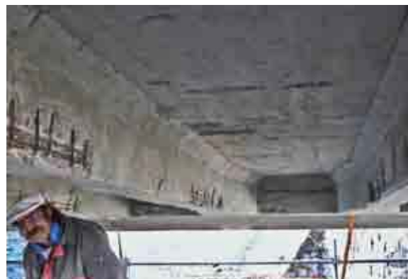
Schäden an den Querträgern
