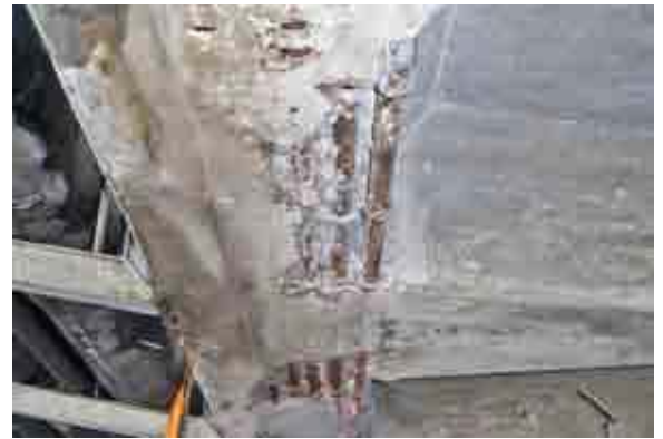
Korrosion an der Hauptbewehrung
