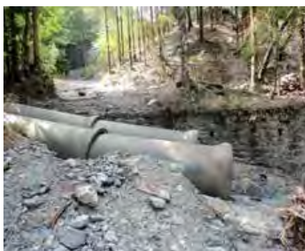
Ein Teil des Hochwassers floss über den Weg ab und spülte Rohre frei.
