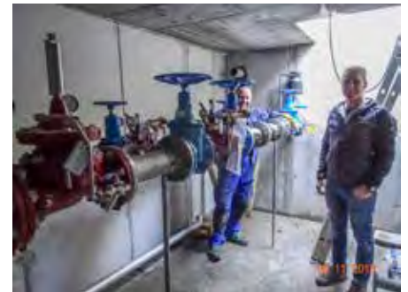
Der Druckunterbrecherschacht von innen.
