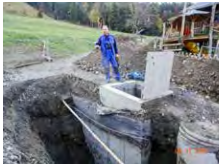
Im Druckunterbrecherschacht Rungeletsch wird der Wasserdruck von 20 auf 4 bar reduziert.
