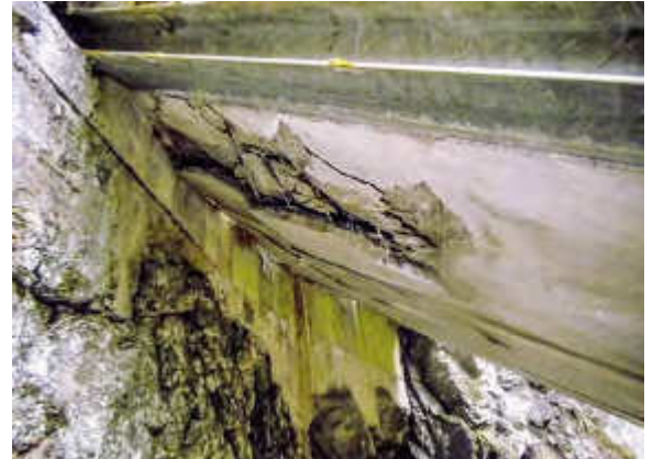
Der Steinschlag hinterließ deutliche Spuren an der Unterseite. Die alte Holzdecke wäre vollständig zerstört worden.
