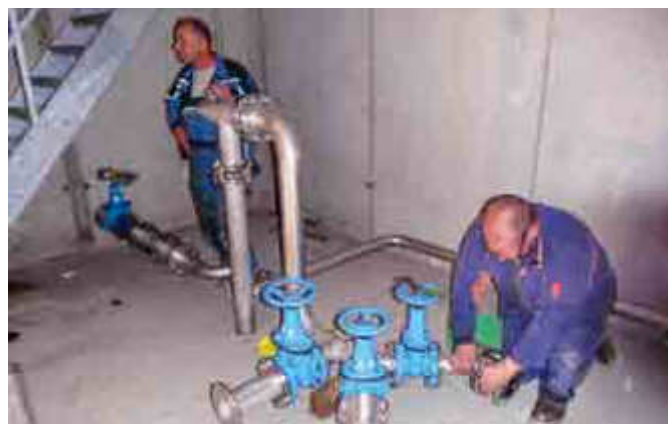
Installation im Pumpwerk. Hier schließen die Leitungen an die UV-Entkeimungsanlagen und die Pumpen an.
