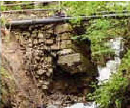
Die alte Brücke, vom Hochwasser unterspült
