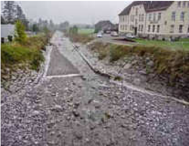
Die ramponierte Sohlrampe
