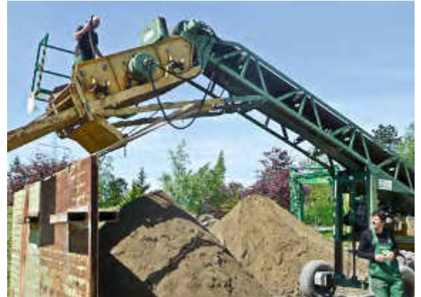
Die Mischanlage funktioniert nur bei trockenem Wetter.
