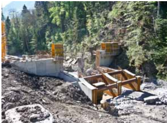
Auf die Rohrbalken wird der Rundrechen gelegt. Der dritte fehlt noch. Darunter kann die Meng ungehindert fließen.
