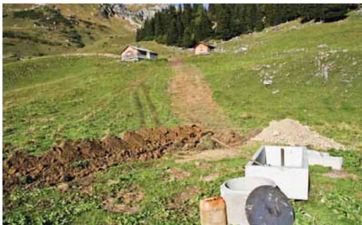
Wasserleitung und neuer Brunnen auf der Alpe Staffeldon
